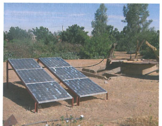
Pompe solaire pour les besoins d'irrigation à Maata-Moulana (Maroc) (A. Bondeau, IMBE)
